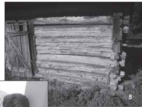
Следы разрушений, вызванных черным домовым усачом в зданиях на о. Рухну
