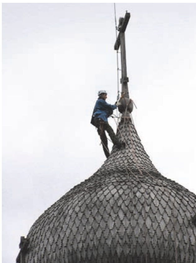
Рис. 5. Обследование состояния креста центральной главы после обнаружения протечки
