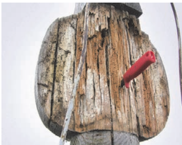
Рис. 8а. Разрушение яблока центрального креста
