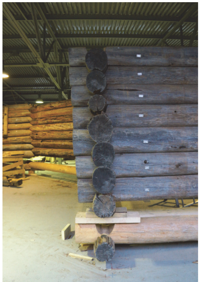
Сильно деформированная часть 6-го пояса, собранного до реставрации в цеху
