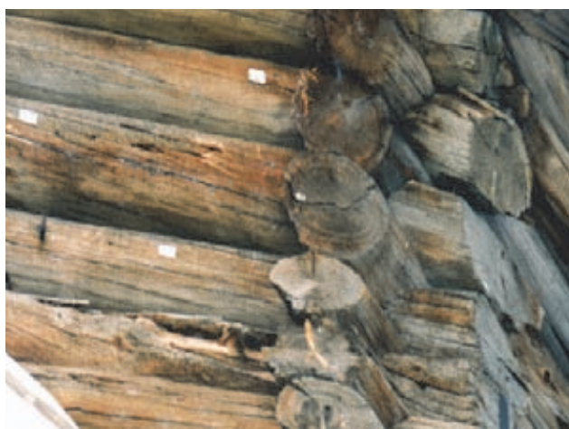
Рис. 5. Разрушение мест врубок бревен третьего восьмерика
